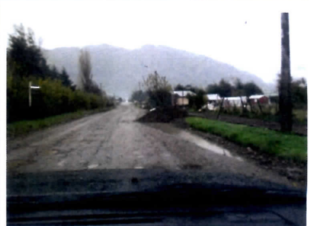
Fotografía N° 4: Baches en calle Bernardo O'Higgins en la ciudad de Puerto Aysén.
