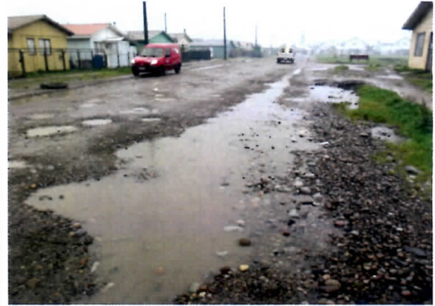
Fotografía N° 6: Baches en calle Constantino Kalstroom, en la ciudad de Puerto Aysén.
