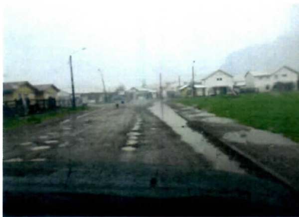
Fotografía N° 7: Baches en calle Constantino Kalstroom, en la ciudad de Puerto Aysén.
