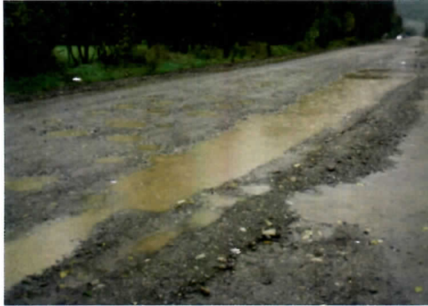
Fotografía N° 1: Baches en calle Pangal, en la ciudad de Puerto Aysén.
