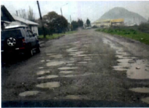
Fotografía N° 5: Baches en calle Bernardo O'Higgins, en la ciudad de Puerto Aysén.
